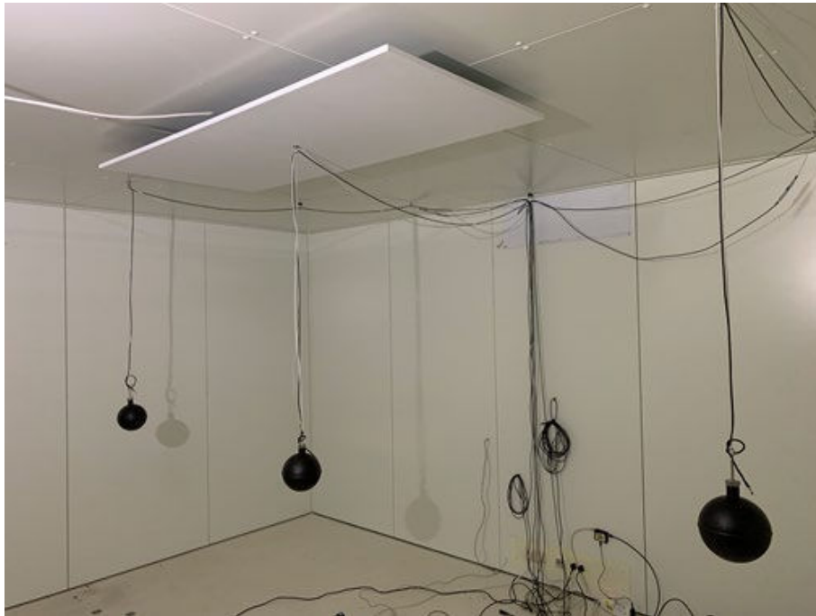
Abbildung 7: Heizgerät Infrarotheizung an der Decke – Position mittig
