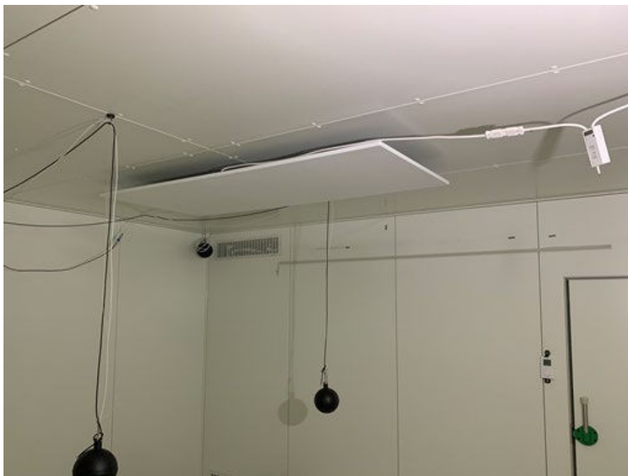
Abbildung 8: Heizgerät Infrarotheizung an der Decke – Position fern
